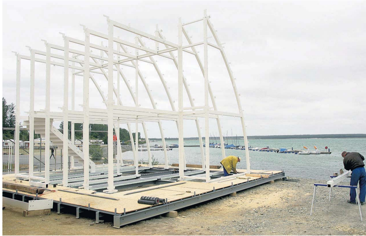
Das Stahlskelett der ersten „ar-che“ für den Wohnhafen Scado ist bereits montiert. Foto: Steffen Rasche
